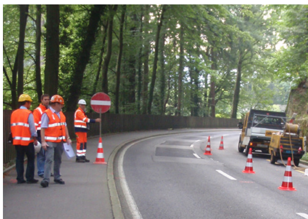
2 Bei kurzzeitigem Aufenthalt im Bereich von Strassen (bis zu einer Stunde) sind mindestens Warnkleider der Klasse 2 (Torso bedeckt) notwendig. Z. B. für Baustellenkontrollen oder Begehungen.
